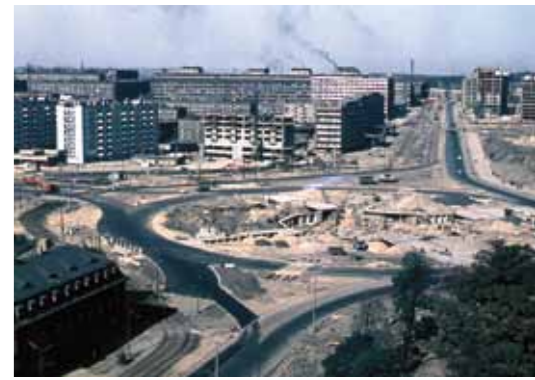
Część podziemna pod rondem wykonana była techniką wykopową wewnątrz utworzonych już jezdni.
